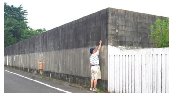
門弟山小プール北側のブロック塀
